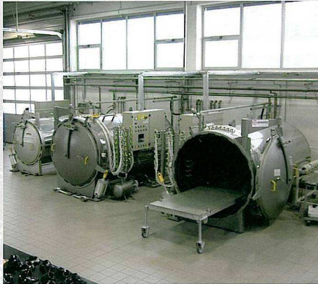
Veduta impianto composto da 2 Autoclavi diametro 1600 mm, lunghezza 3000 mm. e 1 Autoclave diametro 1250 mm, lunghezza 2500 mm, pressione 10 bar, temperatura 220 C° Plant view with 2 Autoclaves diameter 1600 mm, line length 3000 mm. and 1 autoclave diameter 1250 mm, line length 2500 mm, pressure 10 bar, temperature 220 C°
